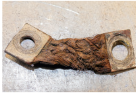
Tauschkandidat: Dieses Stromband ist ein Fall für die Tonne. Die Widerstände maroder Teile addieren sich am Ende zum Totalausfall
